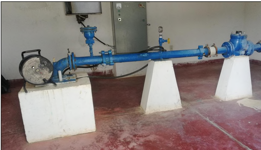
VISTA DEL POZO MORROS BLANCOS A POZO DE OBSERVACIÓN CON LA SONDA PARA MEDICION DE NIVELES PIEZOMÉTRICOS MANUALMENTE
