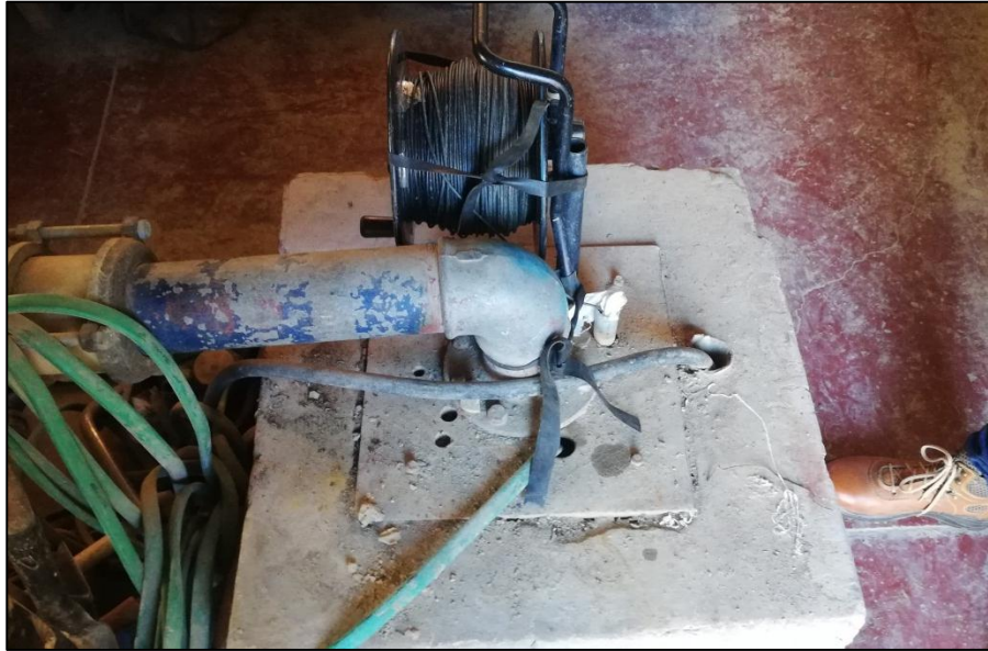
VISTA DEL POZO DE PRODUCCIÓN VILLA FÁTIMA B YA TIENE INSTALADO EL EQUIPO DE MEDICIÓN AUTOMÁTICA DE NIVELES DE AGUA LEVEL LOGGER
