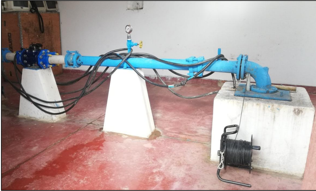
VISTA DEL POZO MORROS BLANCOS B POZO DE PRODUCCIÓN YA TIENE INSTALADO EL SENSOR LEVEL LOGGER PARA MEDICION DE NIVELES AUTOMÁTICAMENTE
