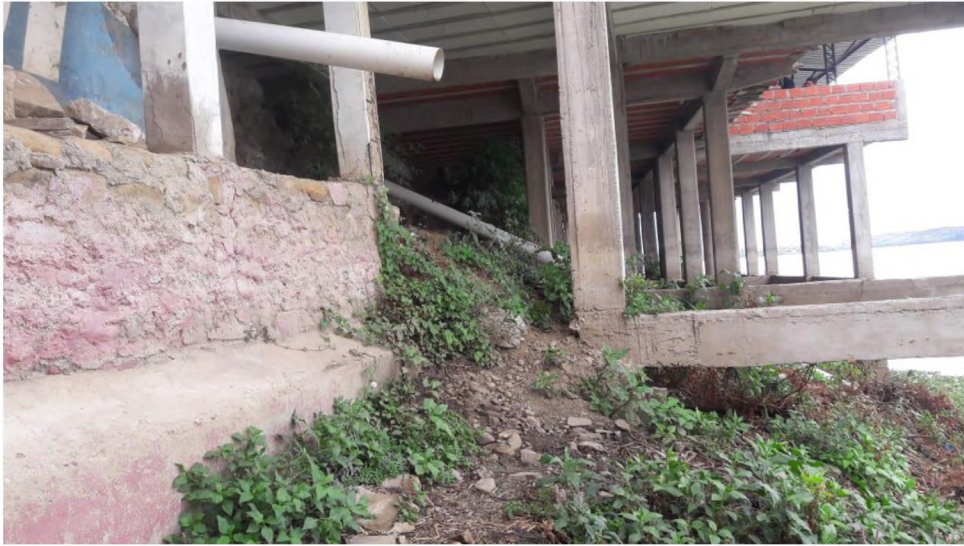
fotografía 5 Punto de descarga del afluyente de las aguas residuales.
