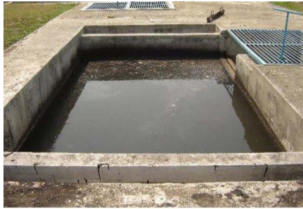
Figura 2 .Imagen de un desgrasador en planta de tratamiento.
