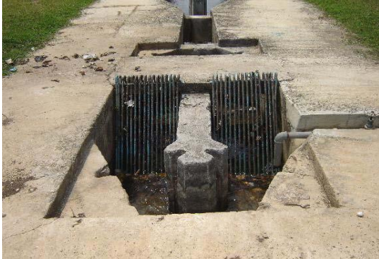
Figura 4. Cámaras de rejás
