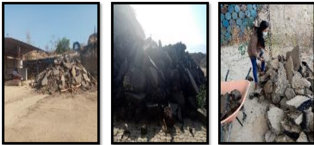
Figura 4.42 Acopio de carpetas asfálticas removidas de las vías urbanas de la ciudad de Tarija
