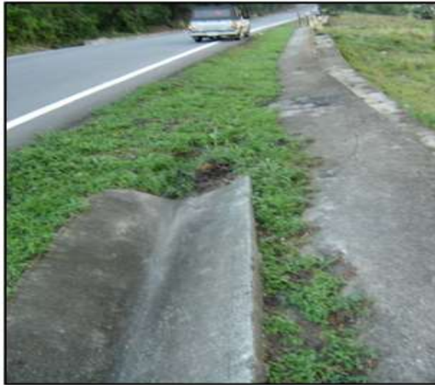
Fotografía 22. Entrega inadecuada del agua conducida por las cunetas.
