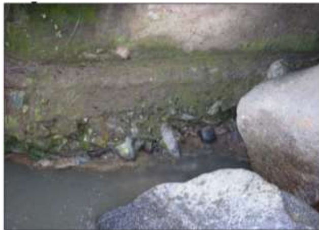
Fotografía 11. Socavación de aleta de alcantarilla
