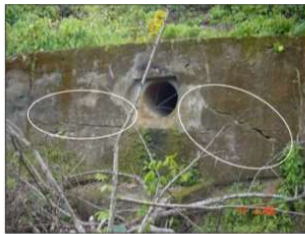
Fotografía 2. Grietas en muro cabezal
