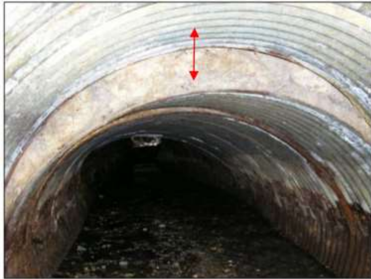
Fotografía 8. Hundimiento o aplastamiento de la tubería
