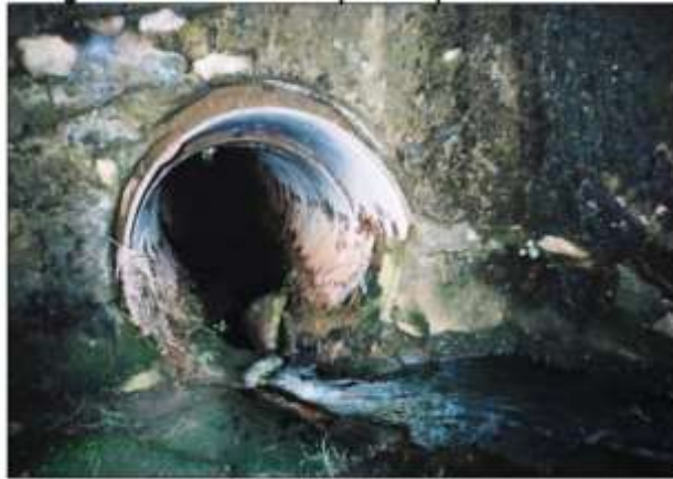
Fotografía 5. Fractura con perdida parcial de tubería.
