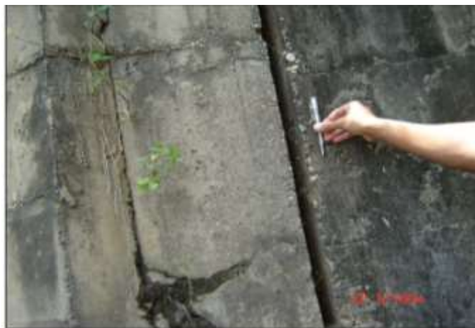
Fotografía 4. Grieta vertical en la unión entre cabezal y las aletas
