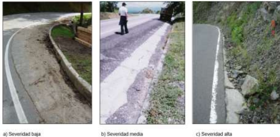
Fotografía 21. Severidades de la obstrucción en cunetas
