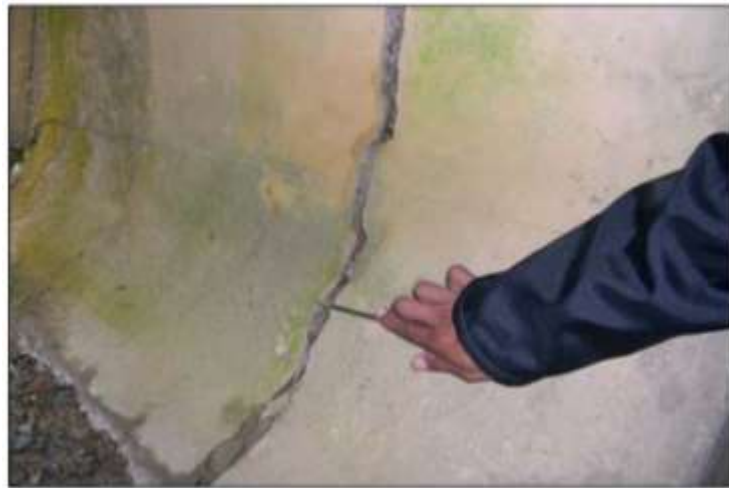
Fotografía 3. Grietas en tubería principal de una alcantarilla
