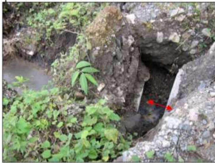
Fotografía 7. Separación de secciones de tubería que han ocasionado inestabilidad del terreno.
