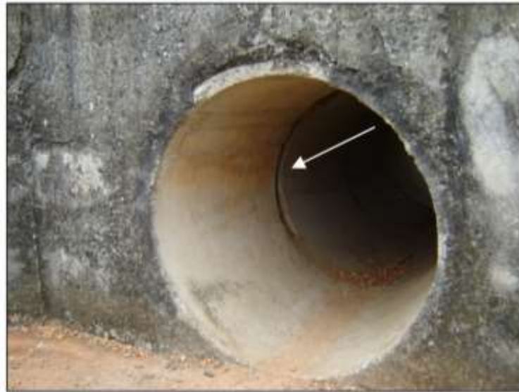
Fotografía 12. Perdida de mortero de pega en la unión de la tubería
