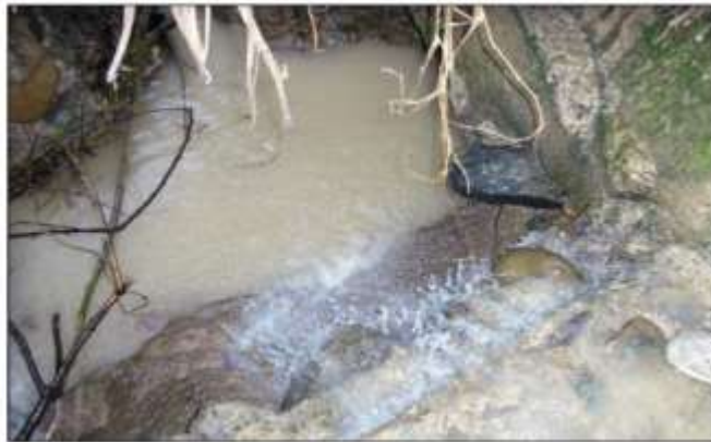
Fotografía 6. Fracturamiento con pérdida del elemento de descole
