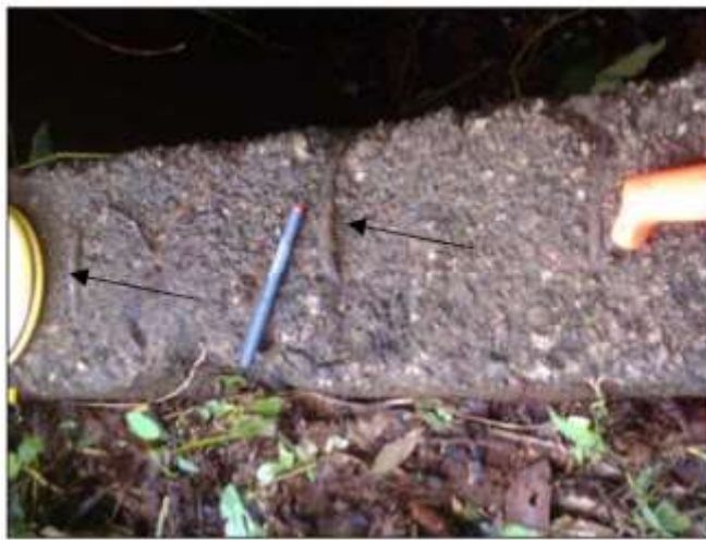
Fotografía 10. Exposición del acero de refuerzo en muro cabezal
