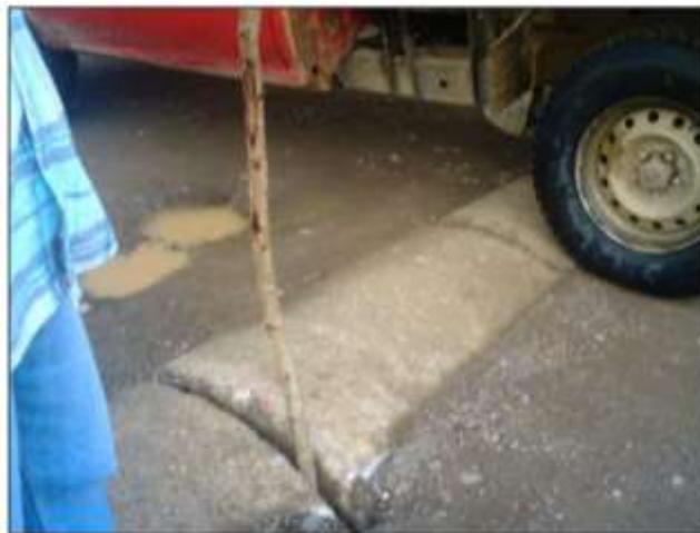
Fotografía 9. Exposición de tubería de alcantarilla con separación de secciones de tubería
