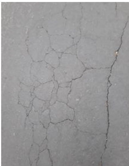
Figura 2.29 Falla piel de cocodrilo
