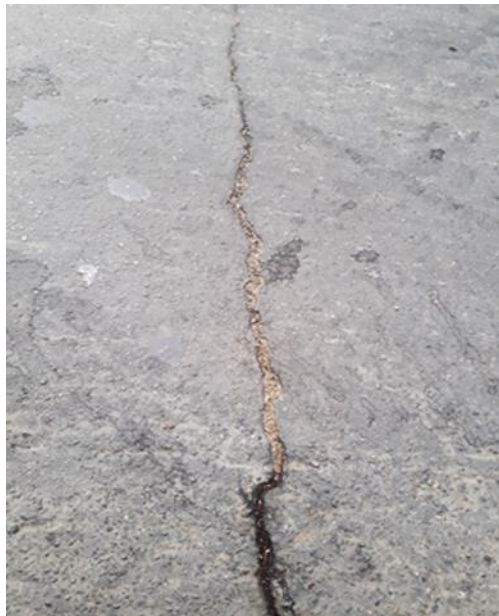
Figura 3.17 Falla grieta transversal - calle Campero
