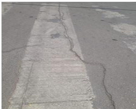
Figura 3.19 Falla grieta longitudinal - calle Sucre
