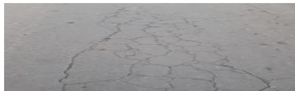
Figura 3.21 Falla Piel de cocodrilo - calle Colón
