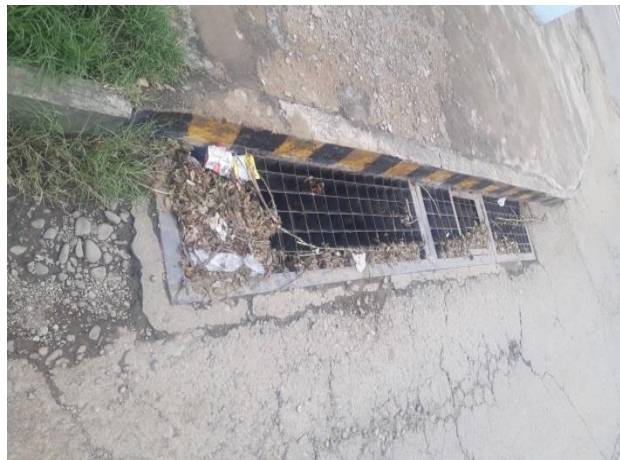
Figura 2.18 Sumidero de reja con presencia de basura
