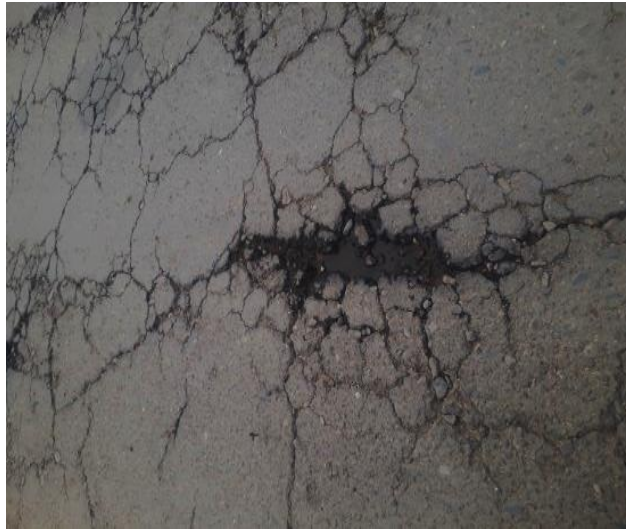
Figura 2.3 Grietas en la capa asfáltica
