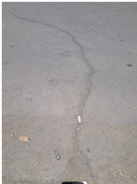
Figura 3.18 Falla grieta transversal - calle General Trigo
