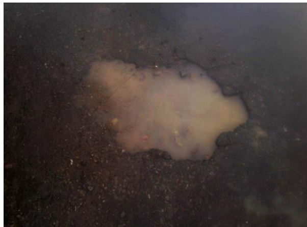
Figura 2.2 Hoyos en la capa asfáltica
