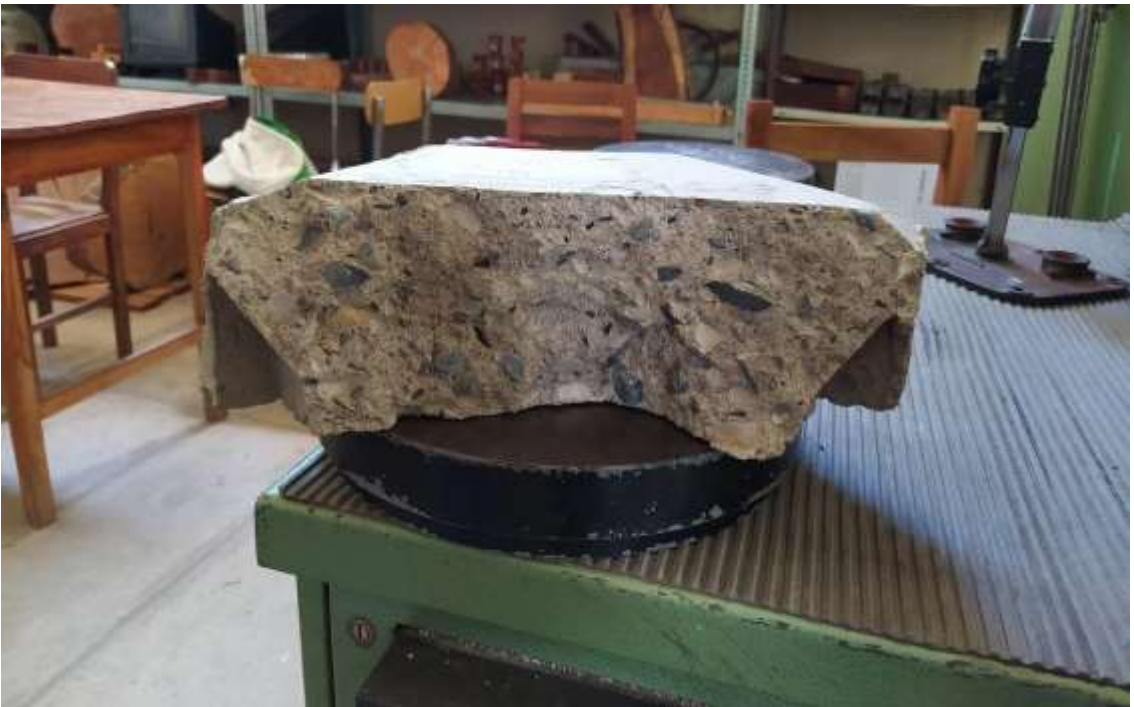
Vista del fallo lateral de la loseta de hormigón
