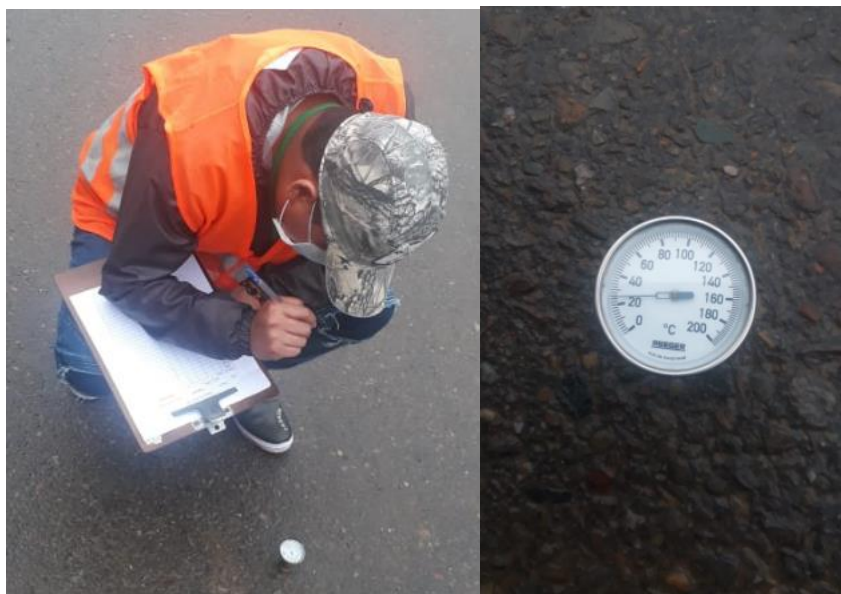
Figura N° 22 Registro de la temperatura
