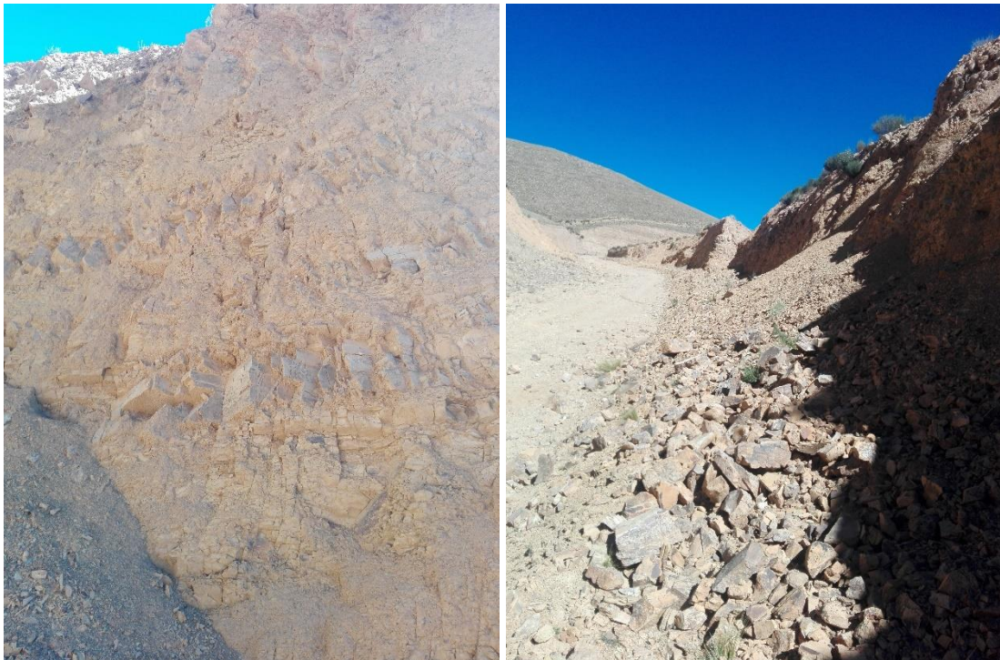
Fallas que se presentan en los taludes
