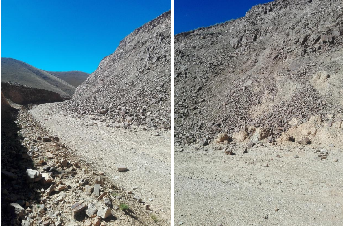
Taludes inestables con deslizamientos
