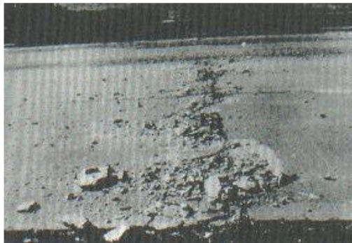
Figura 2.2.3.1 b) Blowup / buckling de baja severidad.
