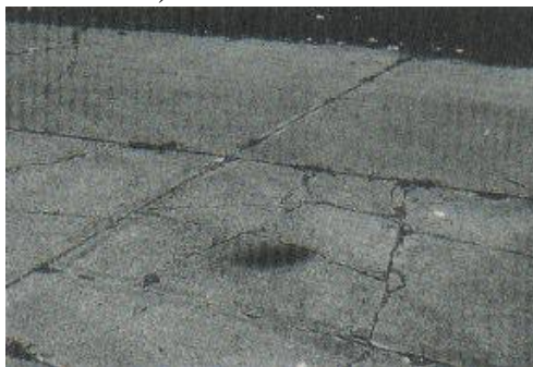
Figura 2.2.3.3 c) Losa dividida de alta severidad.
