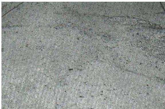
Figura 2.2.3.4 c) Grieta de durabilidad de alta severidad.
