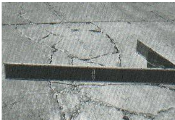
Figura 2.2.3.14 c) Punzonamiento de alta severidad.
