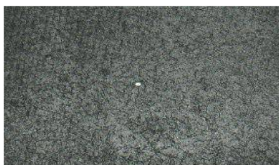
Figura 2.2.3.16 a) Desconchamiento / Mapa de grietas / Craquelado de baja severidad.
