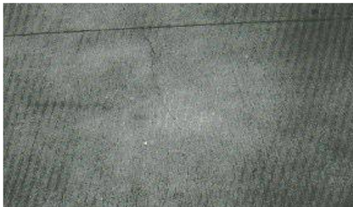
Figura 2.2.3.17. Grietas de contracción.
