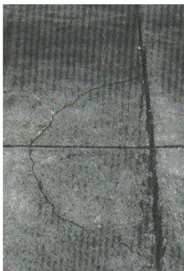
Figura 2.2.3.2 a) Grieta de esquina de baja severidad.
