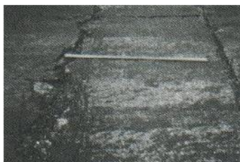
Figura 2.2.3.9 c) Parche grande y acometidas de servicios públicos.
