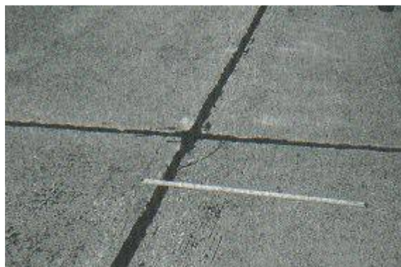
Figura 2.2.3.18 a) Descascaramiento de esquina de baja severidad.
