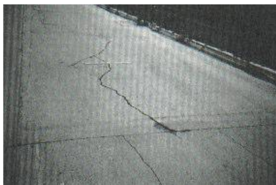
Figura 2.2.3.3 b) Losa dividida de severidad media.
