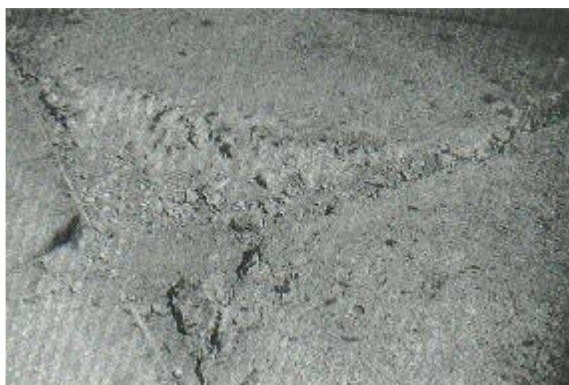
Figura 2.2.3.18 c) Descascaramiento de esquina de alta severidad.
