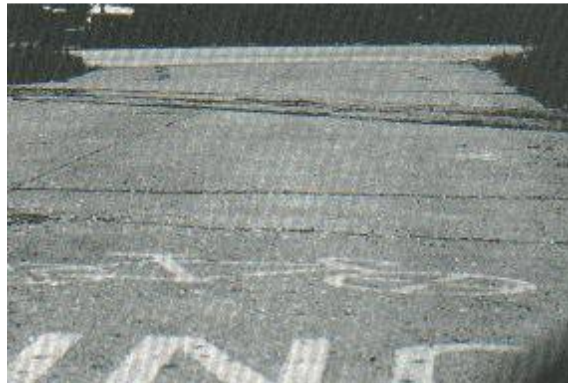
Figura 2.2.3.15 b) Cruce de vía férrea de severidad media.
