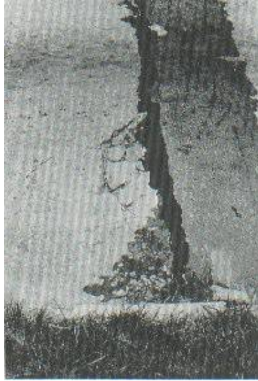
Figura 2.2.3.1 a) Blowup / buckling de baja severidad.
