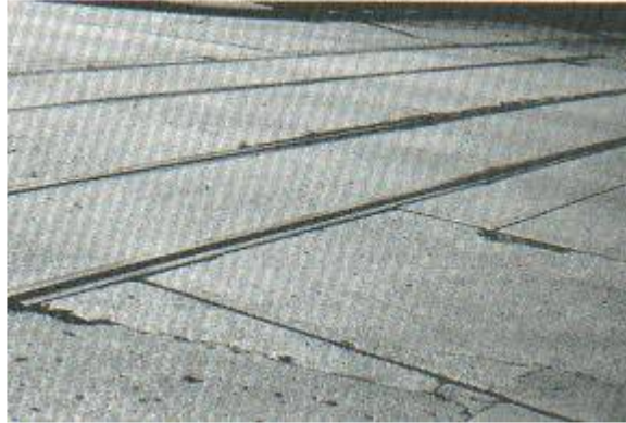
Figura 2.2.3.15 a) Cruce de vía férrea de baja severidad.
