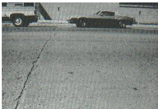
Figura 2.2.3.19 a) Descascaramiento de junta de baja severidad.
