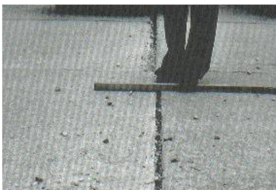
Figura 2.2.3.5 a) Escala de baja severidad.
