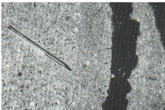
Figura 2.2.3.4 a) Grieta de durabilidad de baja severidad.
