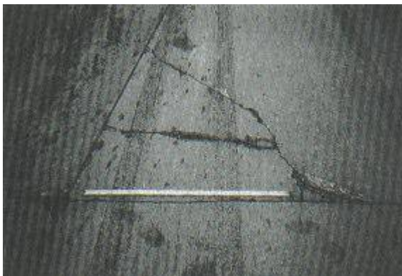
Figura 2.2.3.2 b) Grieta de esquina de severidad media.
