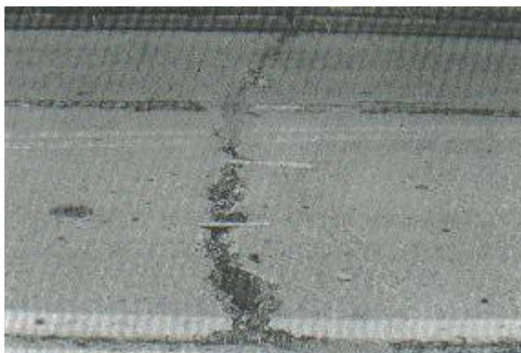
Figura 2.2.3.8 c) Grietas lineales de alta severidad en losa de concreto simple.
