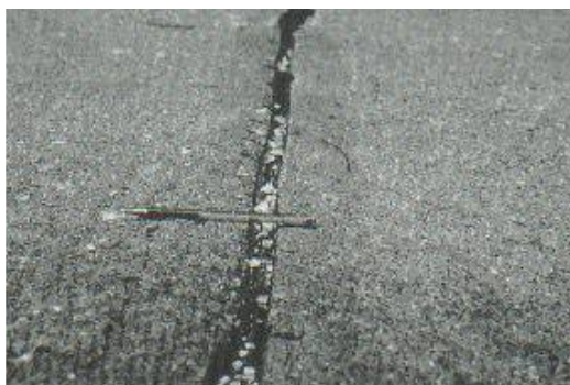
Figura 2.2.3.6 c) Daño del sello de junta de alta severidad.
