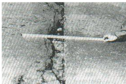
Figura 2.2.3.19 c) Descascaramiento de junta de alta severidad.
