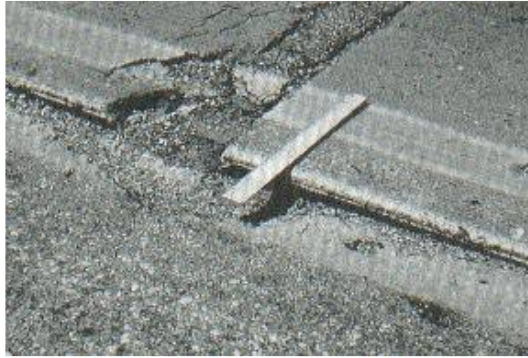
Figura 2.2.3.7 a) Desnivel carril / berma de baja severidad.
