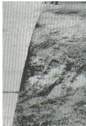
Figura 2.2.3.7 b) Desnivel carril / berma de severidad media.
