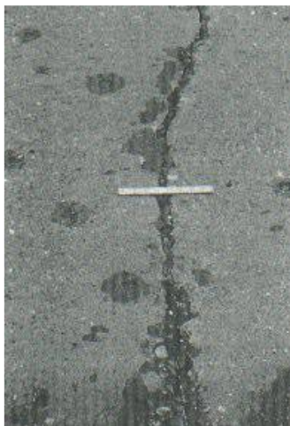
Figura 2.2.3.8 b) Grietas lineales de severidad media en losa de concreto.
