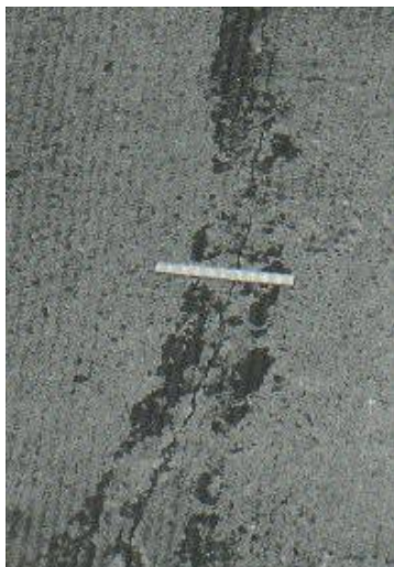
Figura 2.2.3.8 a) Grietas lineales de baja severidad en losa de concreto simple.
