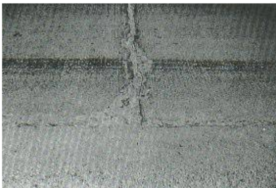
Figura 2.2.3.18 b) Descascaramiento de esquina de severidad media.
