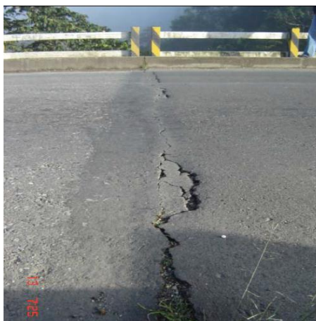
Figura 2.7: Fisuras por reflexion de juntas
