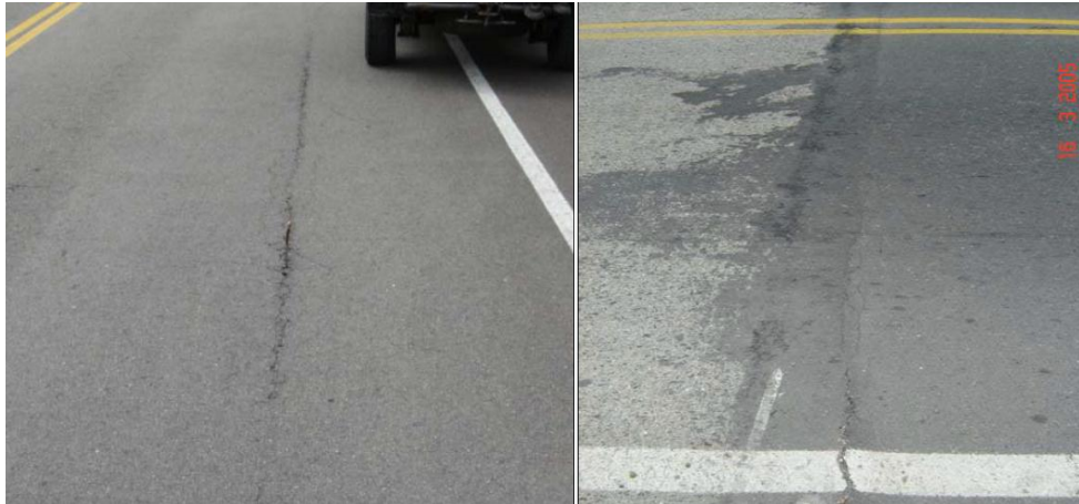
Figura 2.6: Fisuras longitudinales y transversales en juntas de construcción
