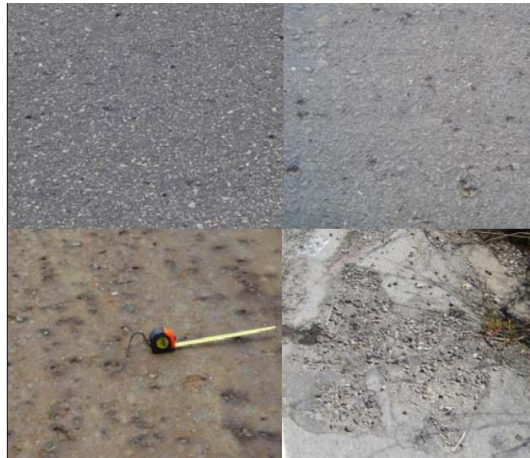
Figura 2.22: Pérdida de agregado
