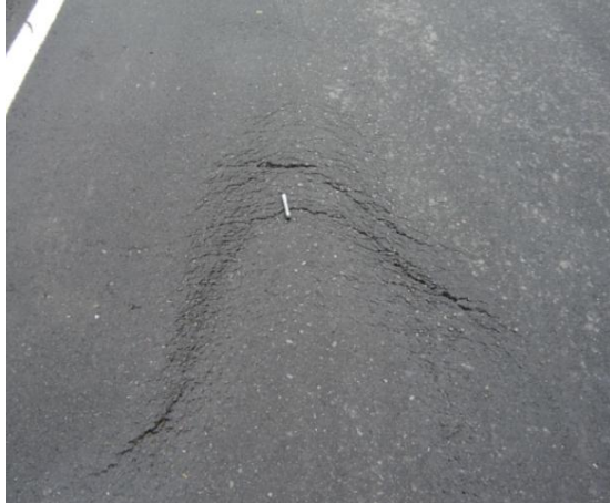
Figura 2.12: Fisuras por deslizamiento de capas
