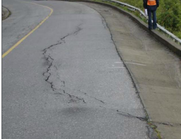
Figura 2.8: Fisuras en media luna
