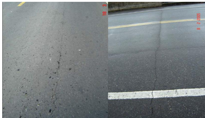
Figura 2.5: Fisuras longitudinales y transversales
