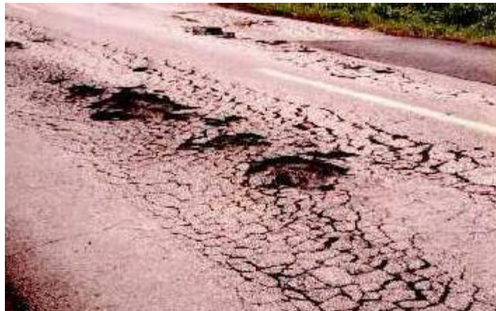
Figura 2.36: Pavimento asfáltico para reconstruir
