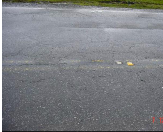
Figura 2.10: Fisuras en bloque
