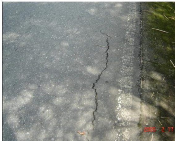
Figura 2.9: Fisuras de borde
