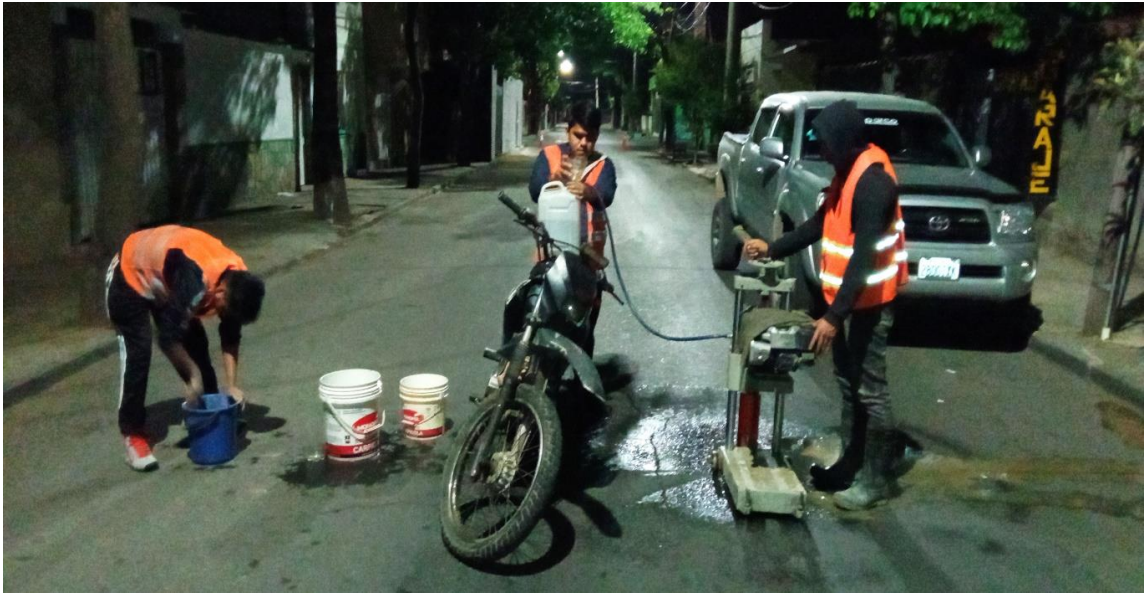
Dotando de agua al extractor.
