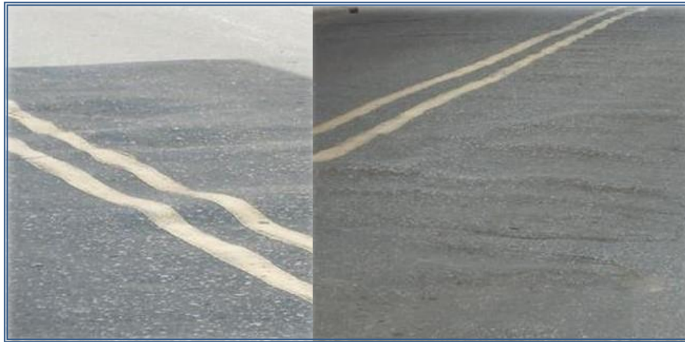
Figura 7. Deformación permanente a nivel de carpeta asfáltica
