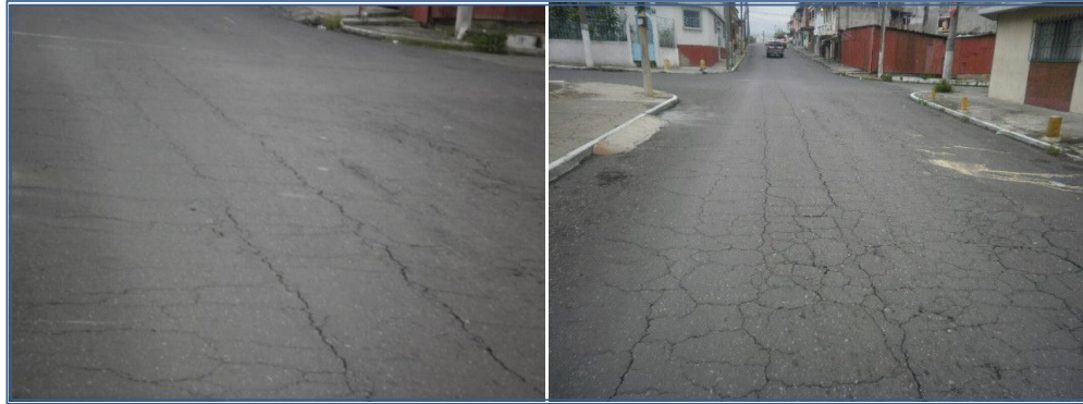
Figura 8. Agrietamiento por fatiga
