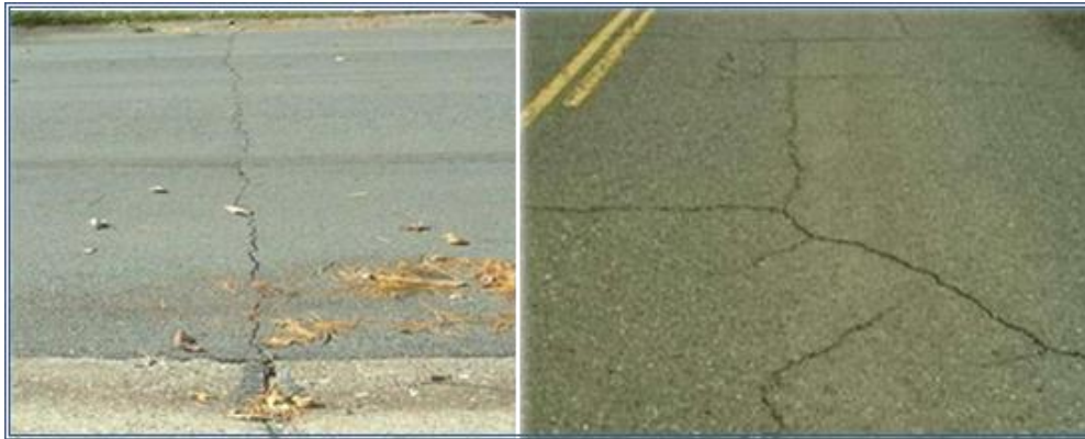
Figura 9. Fisuración por baja temperatura
