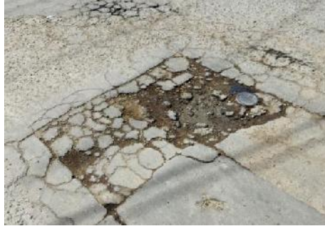
Figura 3. 45 Identificación de la falla.
