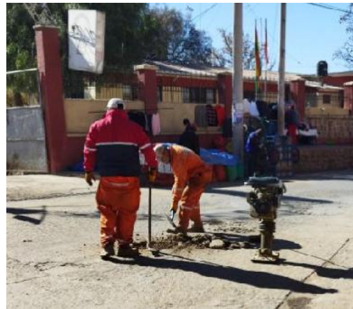
Figura 3. 25 Identificación del área de la falla de la zona.
