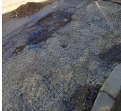
Figura 3. 30 Identificación de la falla.
