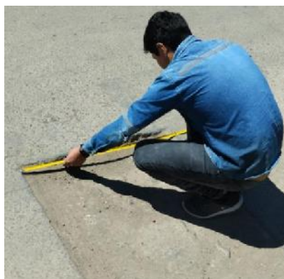
Figura 3. 129 Medición del ancho o sección transversal del bache.
