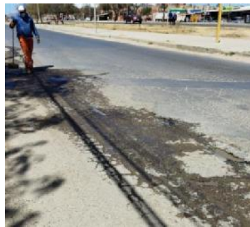
Figura 3. 51 Identificación de la falla.
