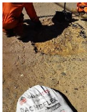
Figura 3. 42 Identificación del bache.
