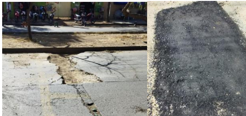
Figura 3. 94 Ubicación de la falla y aplicación de mezcla asfáltica.
