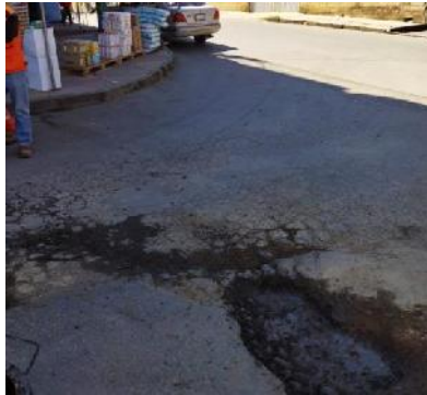
Figura 3. 77 Ubicación de la falla (bache).
