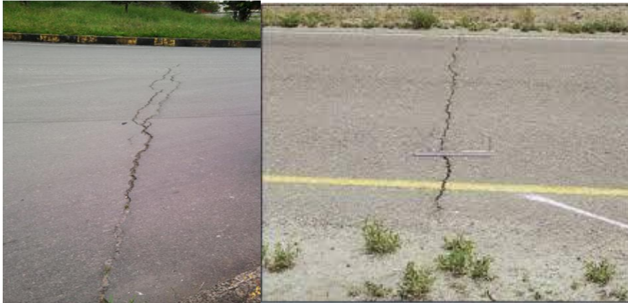
Figura 8 Fisuras transversales en un pavimento
