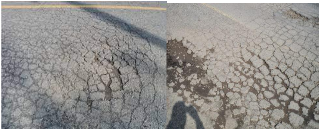
Figura 9 Piel de cocodrilo en un pavimento
