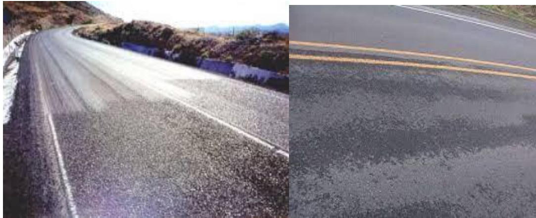
Figura 10 Desprendimiento de agregados en un pavimento
