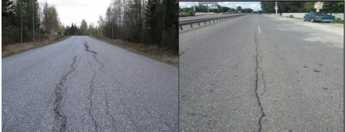
Figura 7 Fisuras longitudinales en un pavimento
