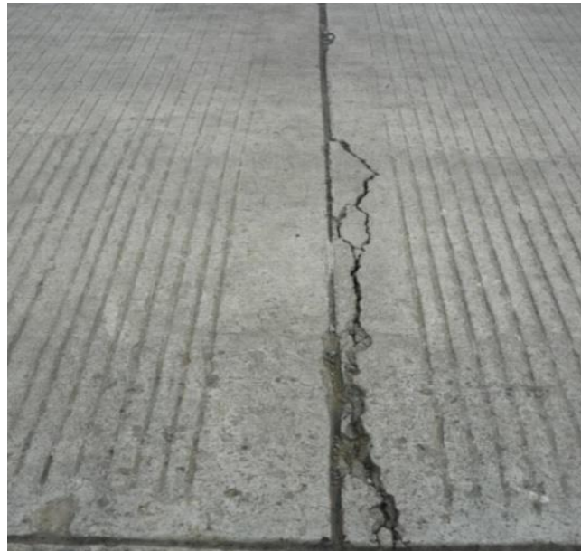
Figura 30 Junta de grieta
