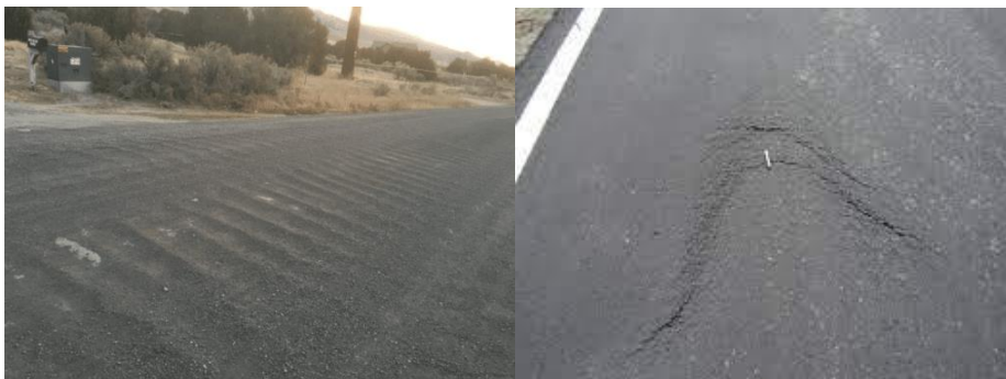
Figura 5 Corrugación en un pavimento
