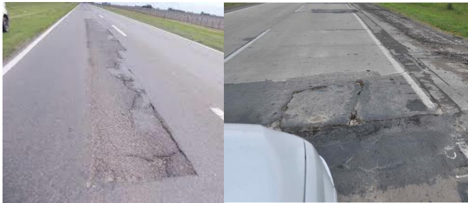
Figura 13 Bacheos en un pavimento
