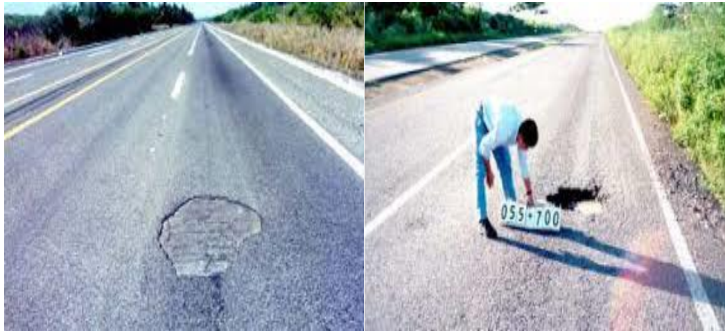
Figura 11 Peladuras en un pavimento
