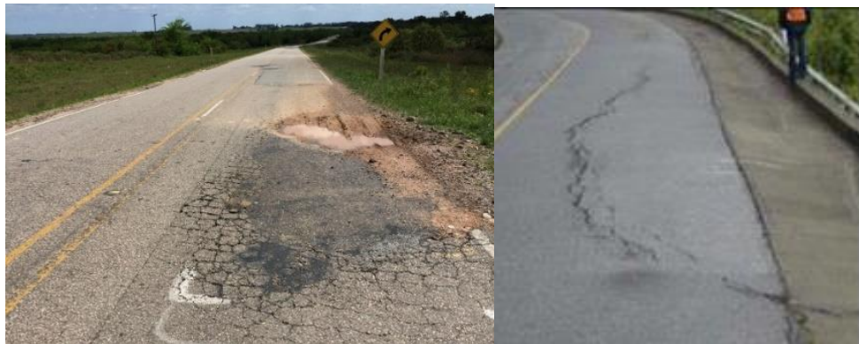
Figura 4 Hundimiento en un pavimento
