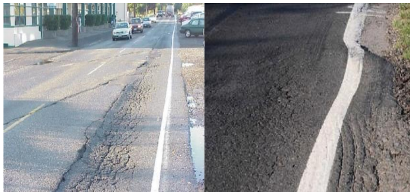
Figura 3 Ahuellamiento en un pavimento
