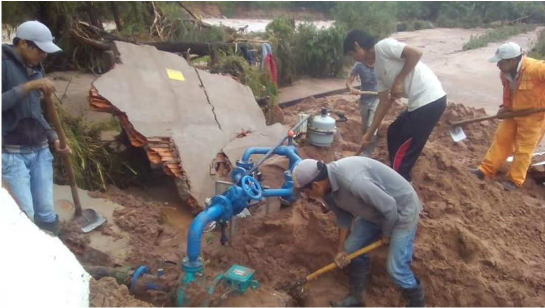
Daños en las obras civiles de la empresa AGRONAYADE
