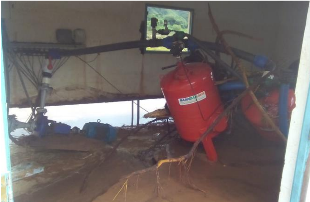
Daños en las casetas de riegos
