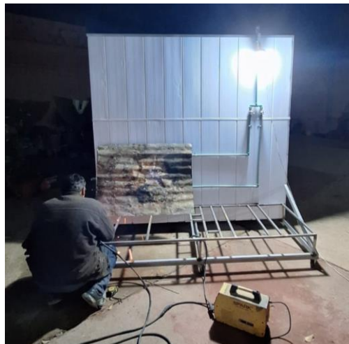
Figura 3.25. Estructura de soporte para sistema de aguas residuales.
