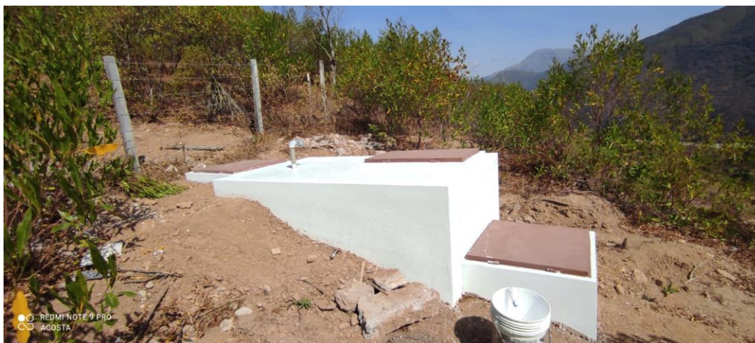
Figura 8. Cámara rompe presión comunidad de llanadas Fuente: Fotografía del autor.
