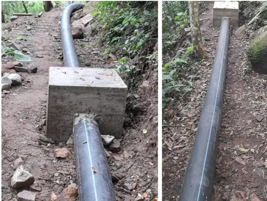
Figura 10 Tendido de tubería PEAD a la intemperie proyecto de micro riego comunidad la Mamora Norte-Tarija Fuente: Fotografías del autor tomada 12/05/2021
