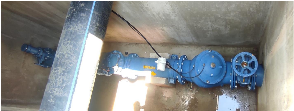
Figura 8 Vista en planta de la estación reductora de presión Barrio 1º de Mayo
