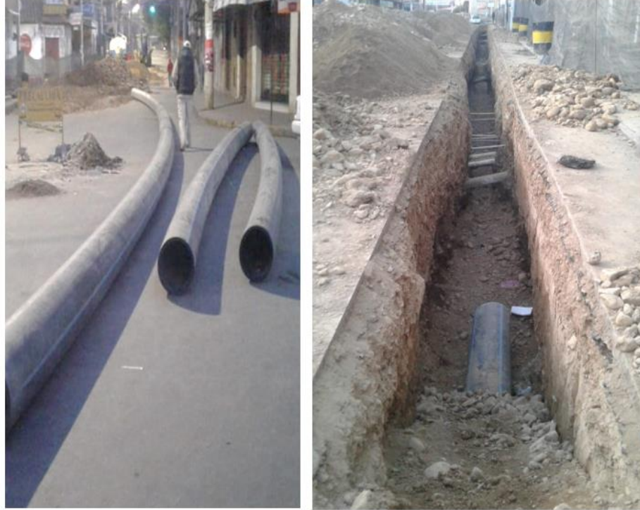
Figura 9 Tendido de tubería PEAD sobre la calle Cochabamba zona de la Loma Tarija Fuente: Fotografías del autor tomada 13/06/20219
