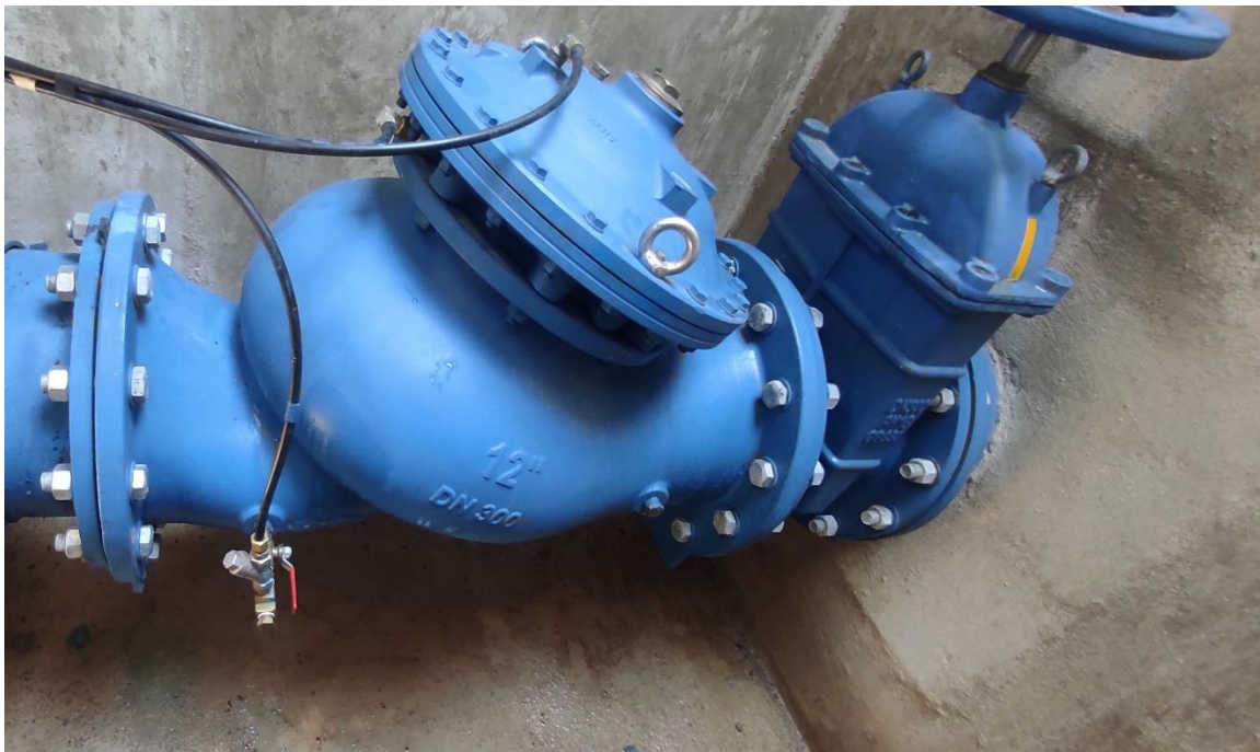
Figura 2 Válvula de control de nivel mega tanque Barrio 1º de Mayo Fuente: Fotografías del autor tomada 7/12/2022
