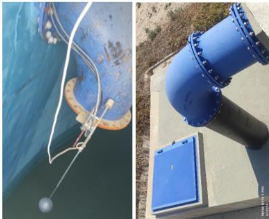
Figura 1 Piloto flotador para un diámetro de 5000mm que acciona a la válvula de control Fuente: Fotografías del autor tomada 7/12/2022
