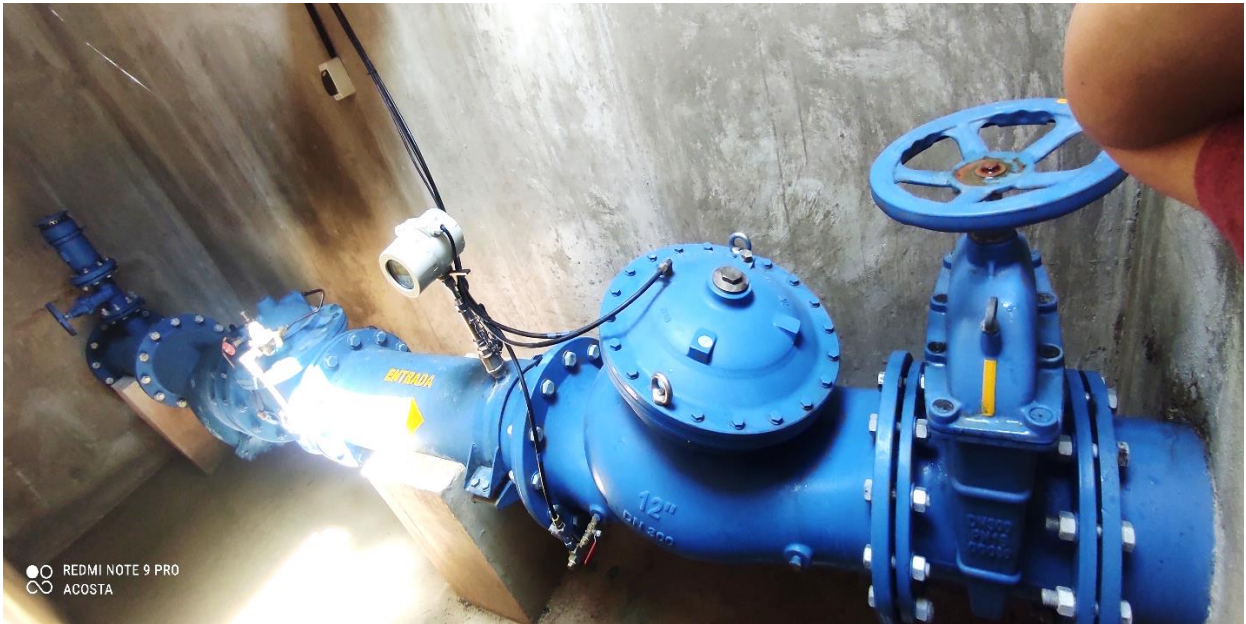
Figura 7 Estación reductora de presión de 12 pulgada compuesta por dos válvulas reductoras, 2 válvula compuerta, filtro de aire y un caudalímetro
