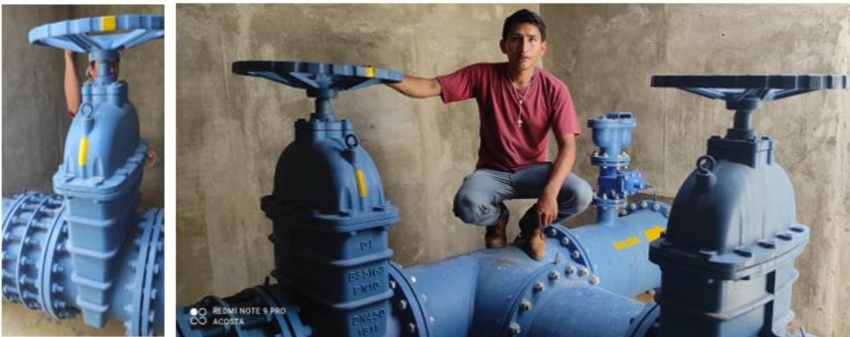
Figura 6 Válvulas compuertas de 12 y 18 pulgadas Fuente: Fotografías del autor tomada 7/12/2022
