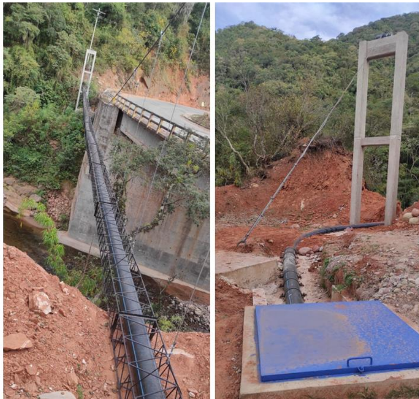
Figura 12 Paso de quebrada con Tubería PEAD puente Santa Ana carretera Entre Rios-Tarija Fuente: Fotografías del autor tomada 10/07/2022
