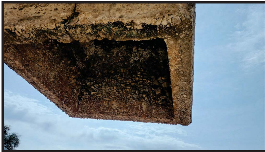
Figura N°78: Salida Del Canal Vista Interior Corrosion Agregado Grueso Expuesto
