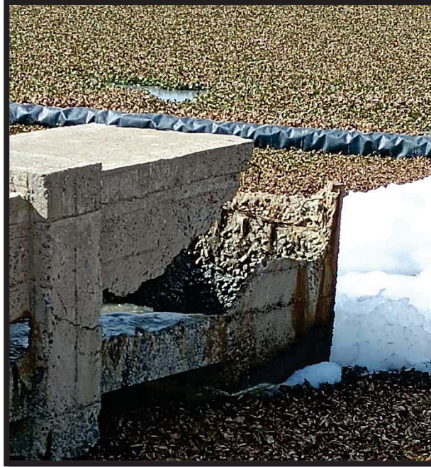
Figura N°75: Armadura Expuesta del Hormigón Armado de Alcantarilla de Entrada a Segunda Laguna Facultativa.
