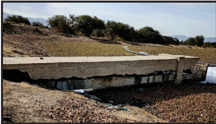
Figura N°76: Rotura Longitudinal en Toda su Extrutura de Alcantarilla de Entrada a la Segunda Laguna facultativa
