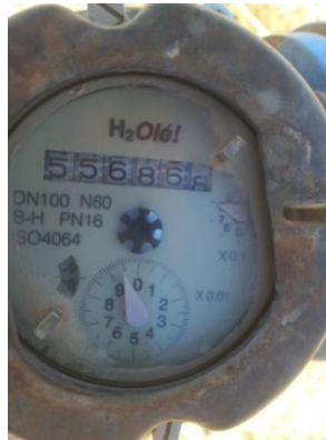
Figura 65 Medidor de caudal dañado
