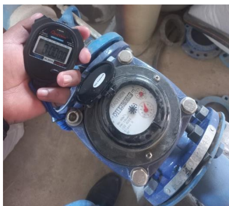
Figura 116 Medidor de caudal, pozo ALBAT
