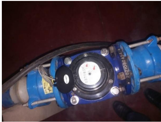
Figura 110 Medidor de caudal, pozo AVIT B
