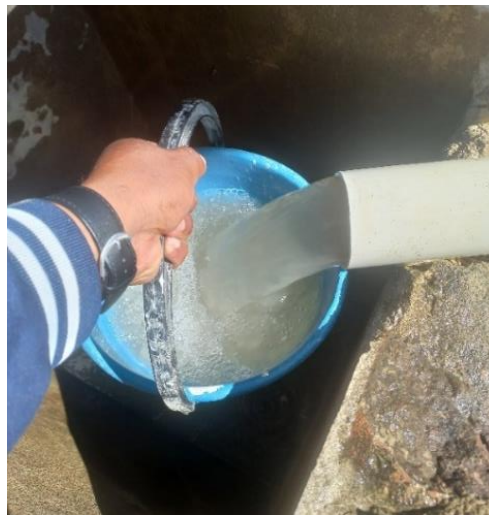
Figura 53 Aforo del caudal, pozo San Jorge II
