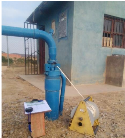
Figura 42 Medición del nivel dinámico, Pozo 27 de mayo
