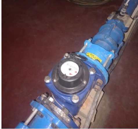
Figura 104 Medidor de caudal, pozo AVIT A
