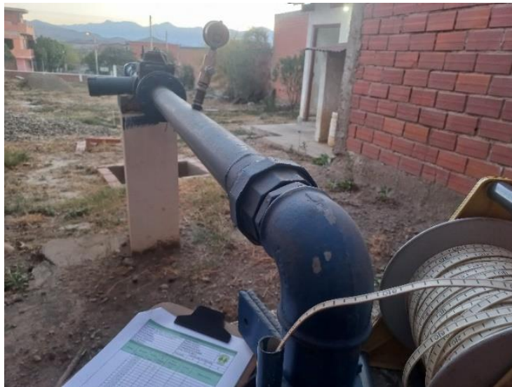
Figura 70 Medición del nivel dinámico durante el bombeo, pozo San Salvador
