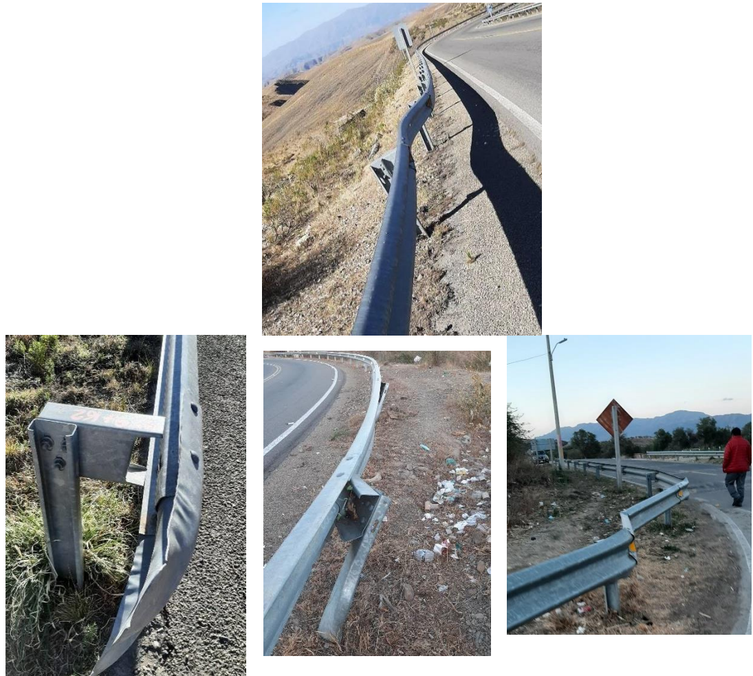
Imagen 3.6 Barreras en mal estado
