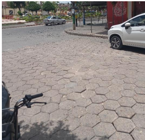
Figura 4.1 Falta de señalamiento horizontal intersección 11
