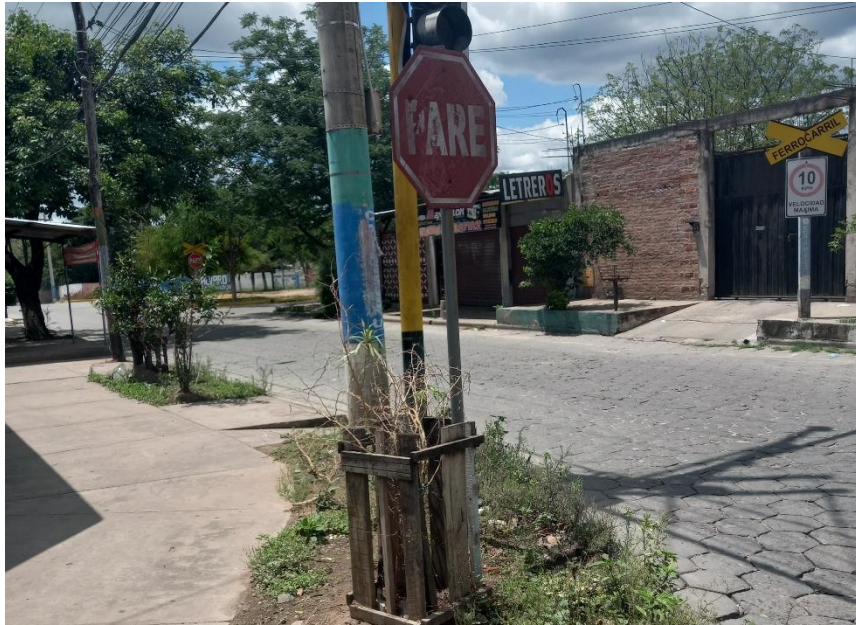
Figura 4.9 señalización vertical con desgaste en las letras intersección 7
