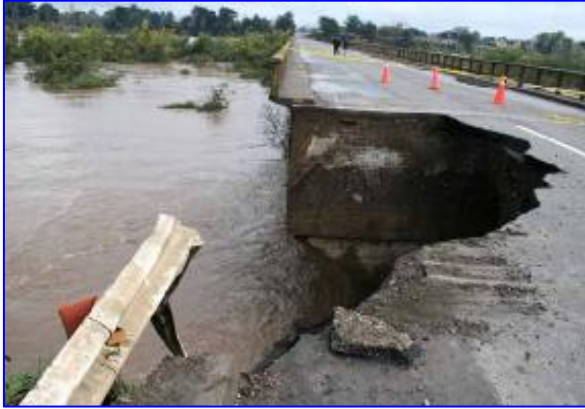
Fig. 1.1 Rotura del Puente en Medellín-Colombia
