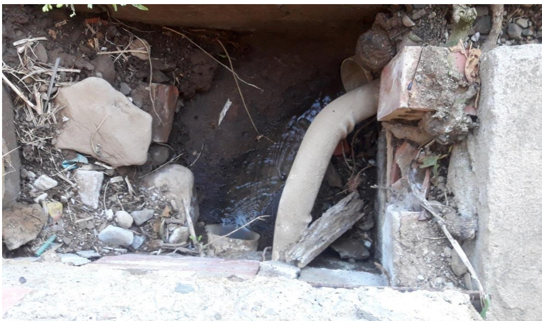
Figura 2- 12: Cámara de inspección salida de sanitarios de varones-Unidad Educativa Yesera Norte
