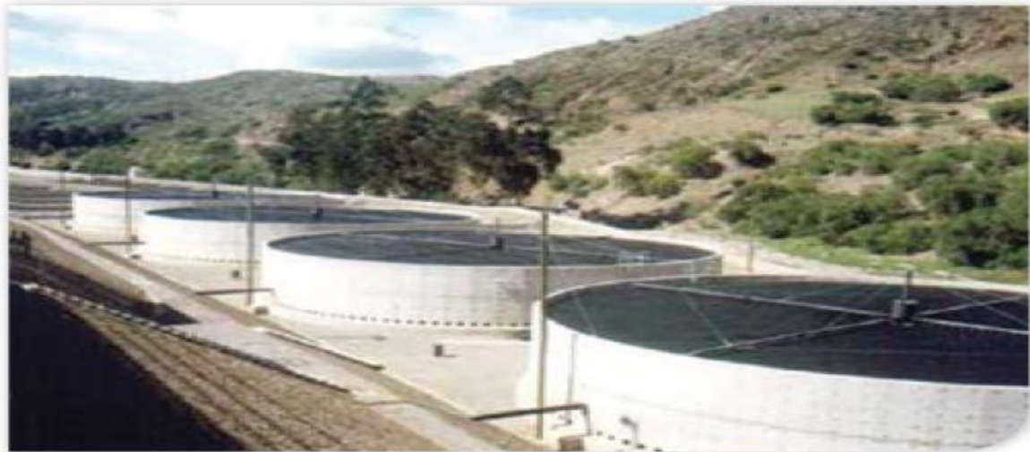
Figura 1- 12: Filtros percoladores en la ciudad de Sucre
