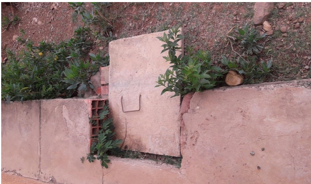
Figura 2- 9: Cámara de inspección salida de sanitarios mujeres-Unidad Educativa Yesera Norte
