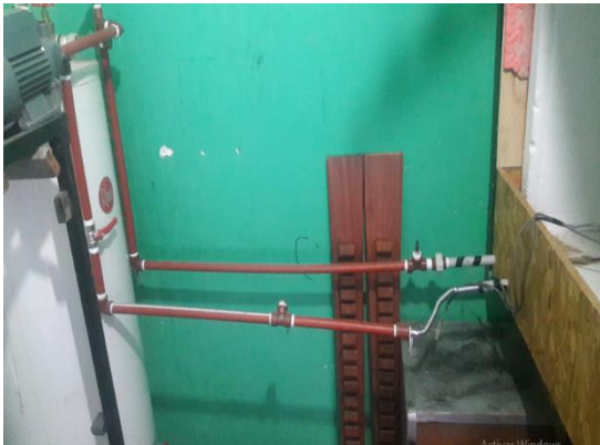
Imagen III - 7 Calefón instalado al secador.
