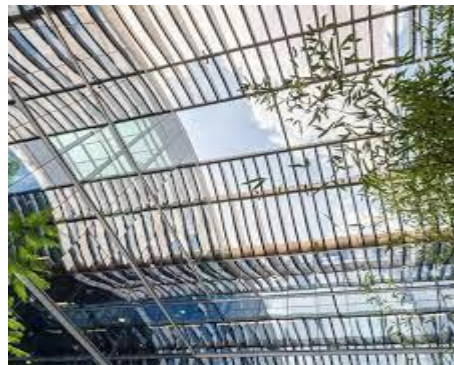
FIG.14 Paneles fenólicos y metal
