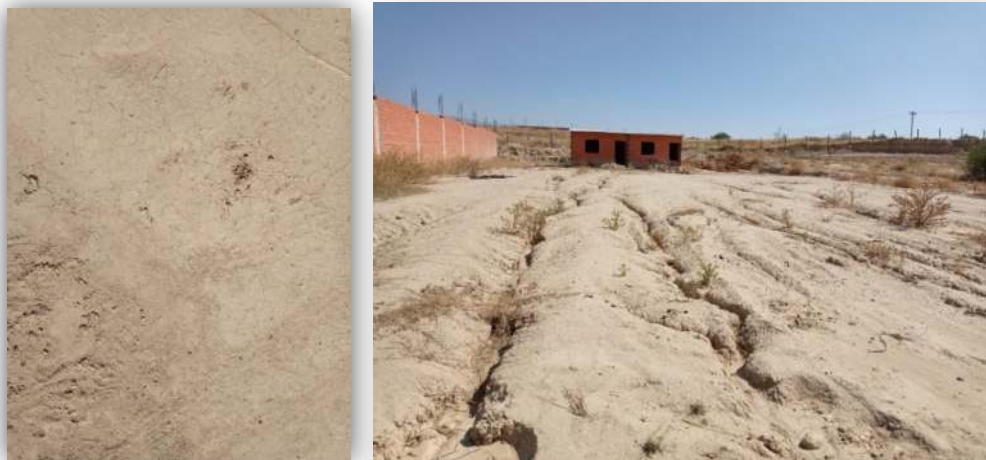
Figura 18: Estado de Erosión
