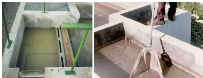
Figura 21. Extracción de las grasas mediante tuberías acanaladas y recogedor de grasas.
