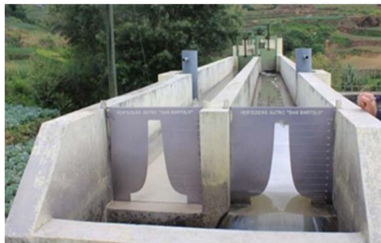
Figura 16. Vertederos Sutro en canales desarenadores de flujo constante
