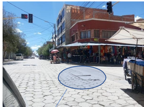
Figura N. ° 58 Vías en mal estado
