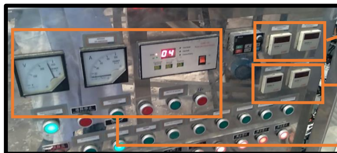
Figura 3-4. Tablero de molino y mezcladores
