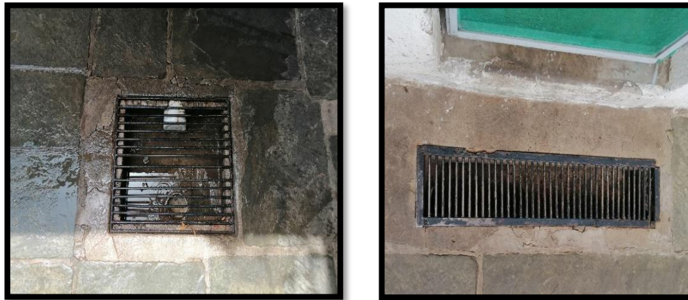
Figura 3-6 Canales de desagüe
