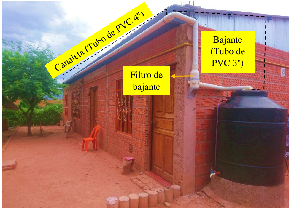
Foto 2, 3, 4: Sistema de conducción del agua captada.
