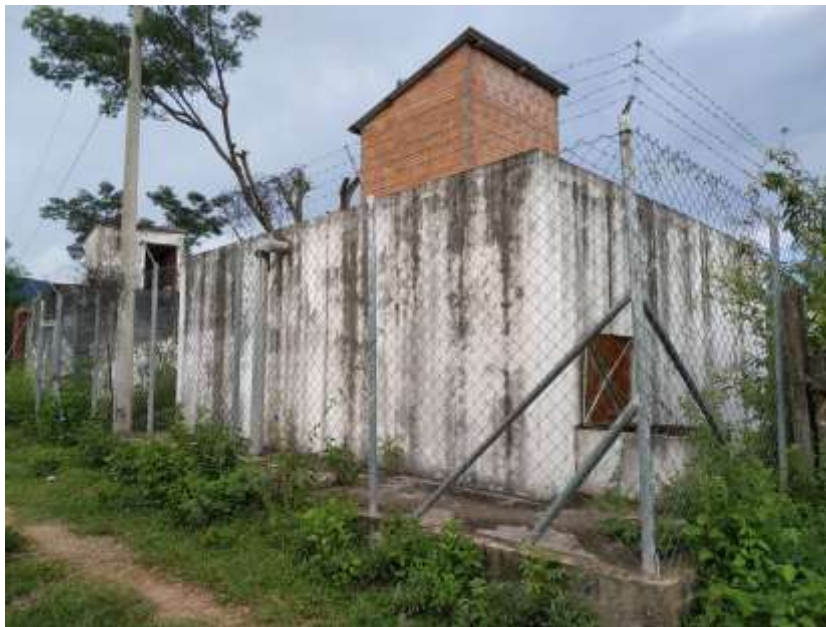
Imagen 25. Tanques de Almacenamiento.
