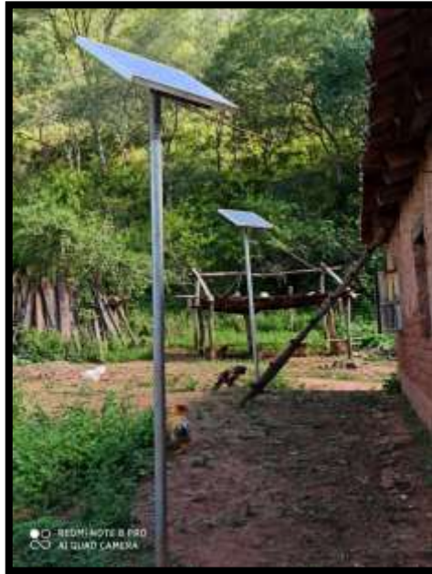
Panel Solar ya instalado.
