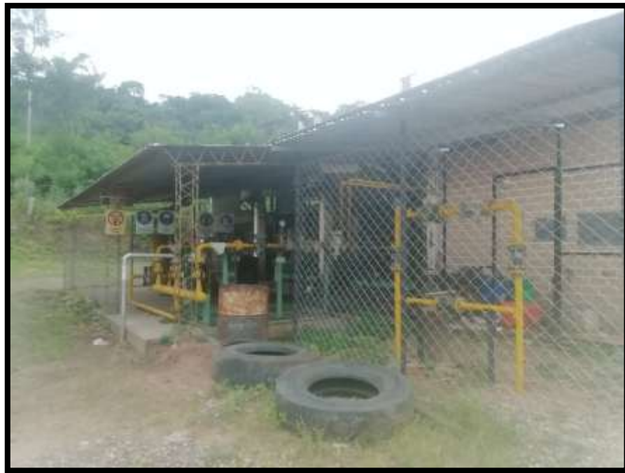
Lugar de los gasoductos donde es transportado el gas para el funcionamiento de los motores.
