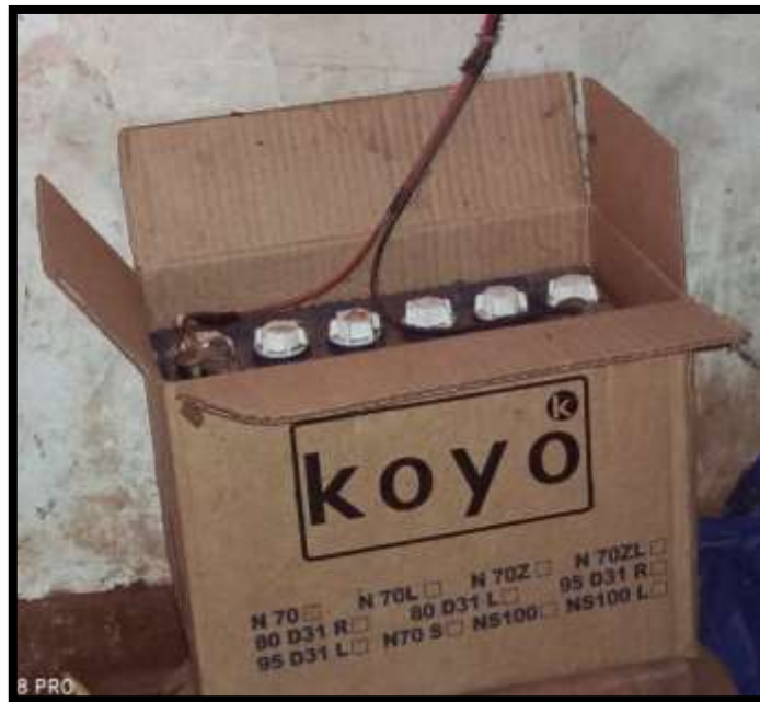
Kit del primer panel solar donde podemos observar el regulador de la carga y la batería.
