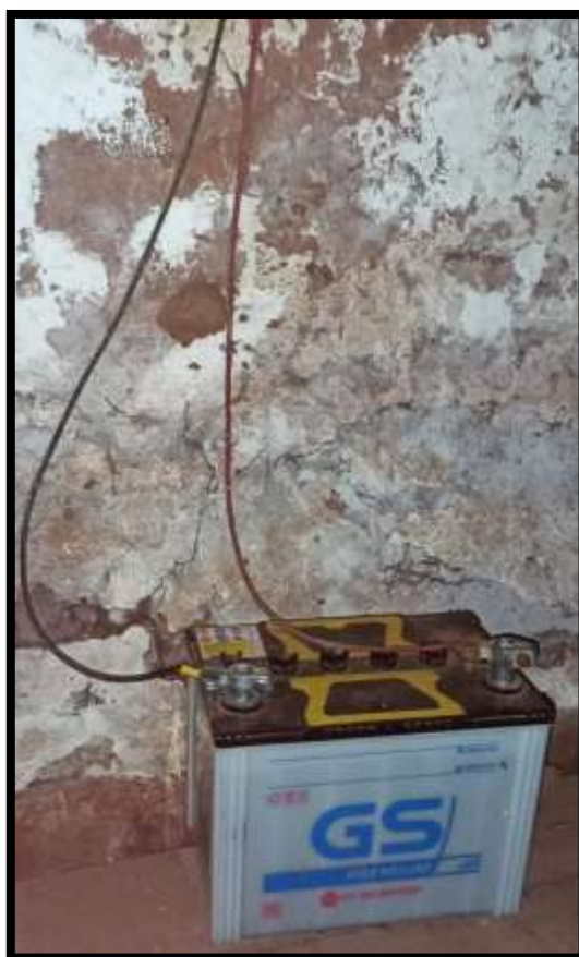
Kit del segundo panel solar donde igual cuenta de regulador y de la batería.
