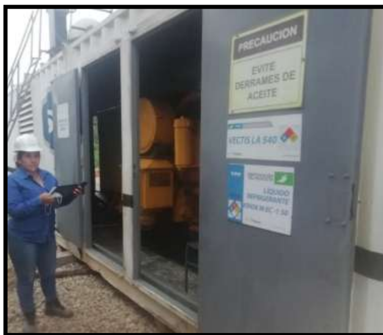
Conociendo los motores a Gas y viendo su funcionamiento.
