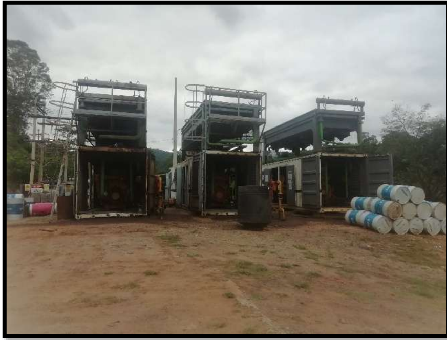
Los tres motores a gas, que con su funcionamiento dotan de energía a la población de Entre Ríos.
