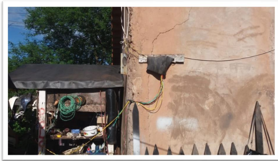
SISTEMA ELECTRICO DEFICIENTE
