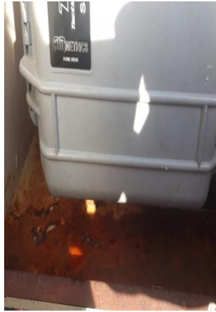
Afectacion de lluvia en la caseta
