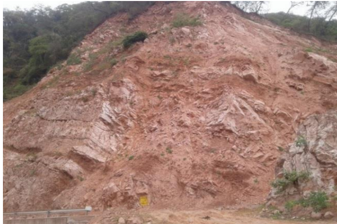
Ilustración 5 CORTE DE TALUD INADECUADO
