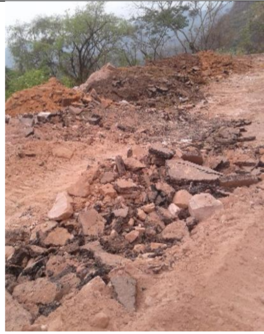
Resto de escombros
