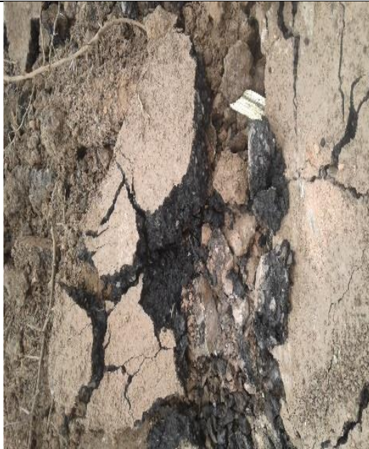
Residuos de asfalto
