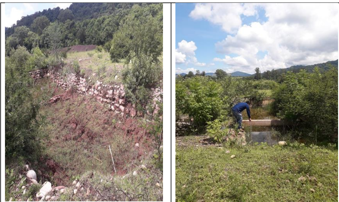
Piscina abandonada sin cierre
