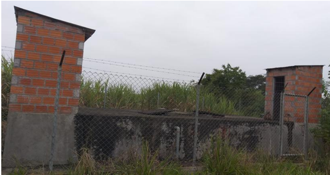
Figura N° 7 Tanque de almacenamiento
