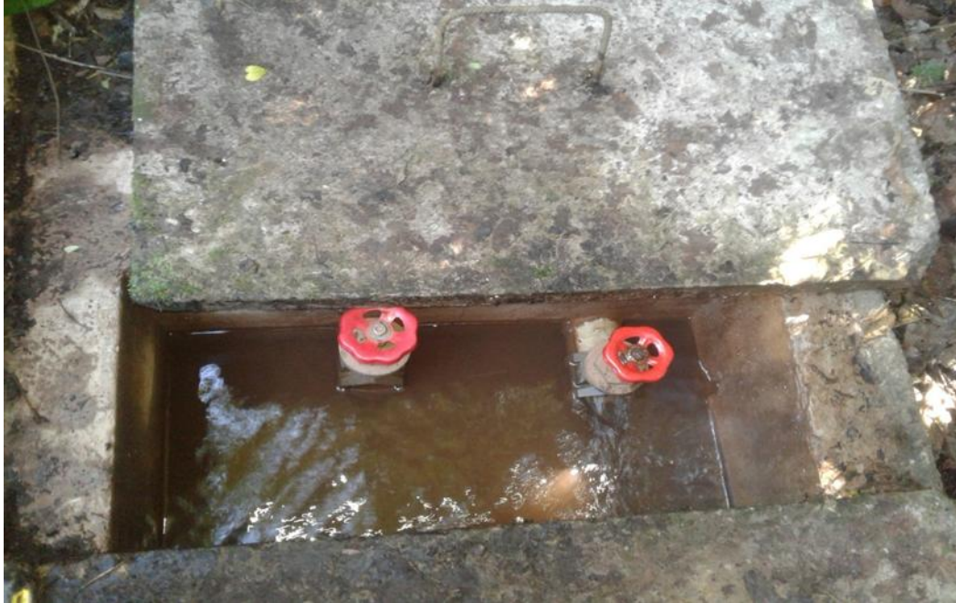
Figura N° 6 Cámara de aducción
