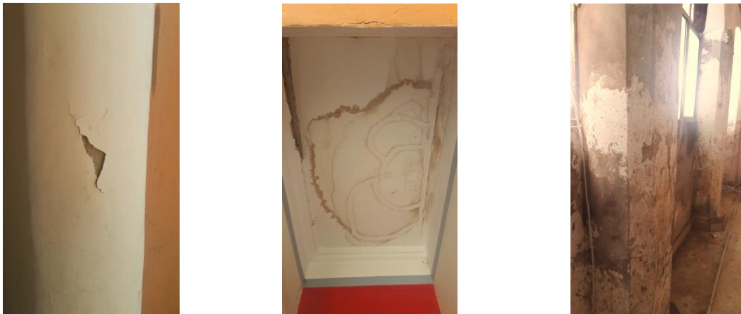
Figura 53. Grieta, humedad, corrosión y desprendimiento de material.
