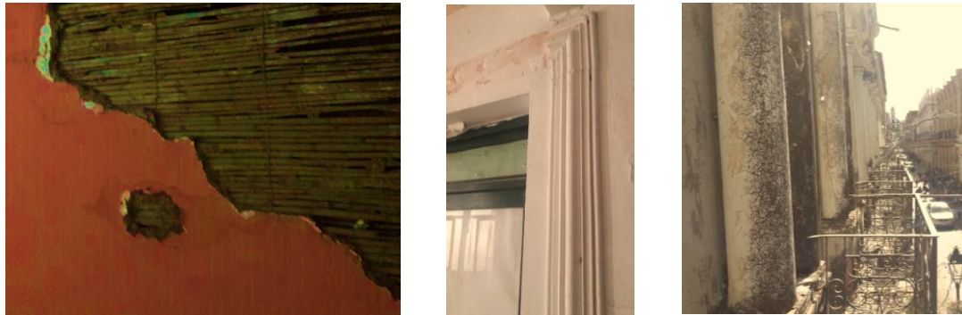
Figura 54. Caída del techo, desprendimiento de material y corrosión.
