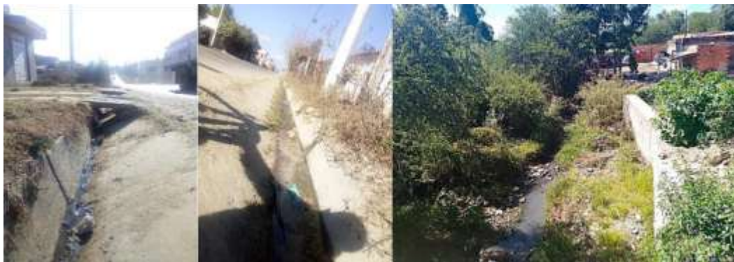
Fig. 33. Cunetas usadas para la evacuación de aguas residuales, y quebradas contaminadas.
