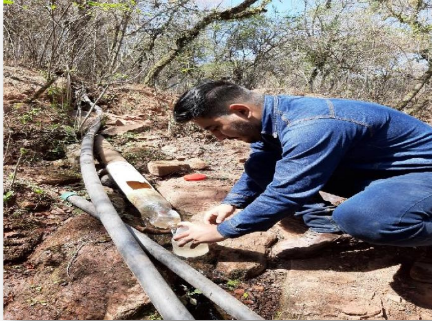
Imagen 12. Segunda toma de muestras y caudales en cañería que no llega hasta el hogar 10 metros de la casa P4
