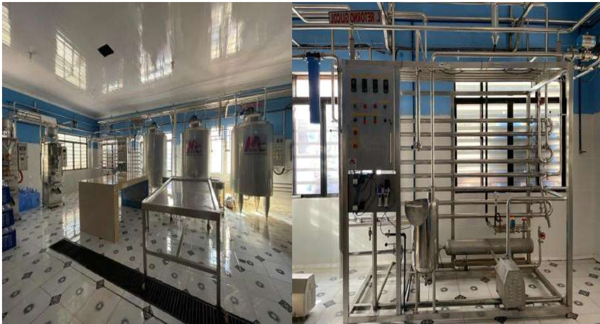
Sala de producción de CMTCC, Tanques de almacenamiento, pasteurizador tubular,
