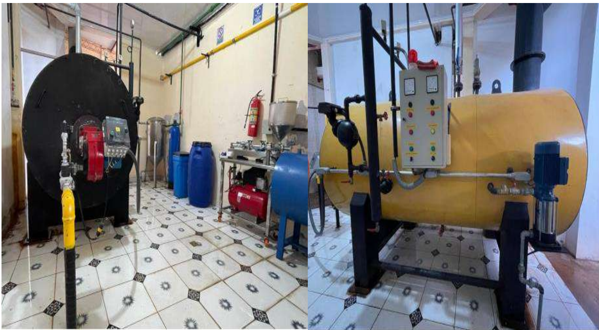
Sala de caldero del CMTTC (2023)
