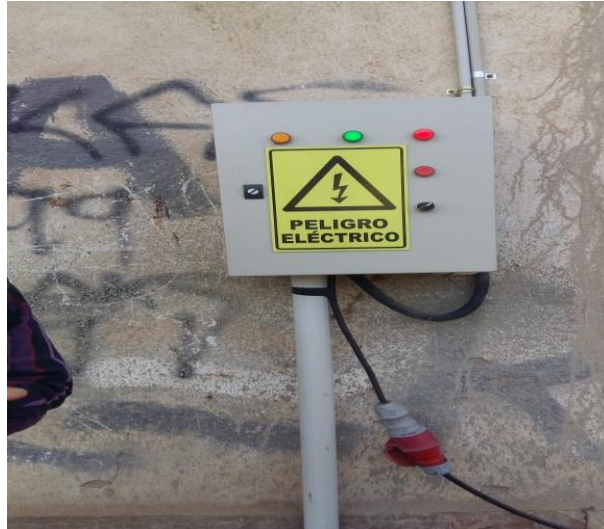
FIGURA D-5 TABLERO ELÉCTRICO DEBIDAMENTE SEÑALIZADO
