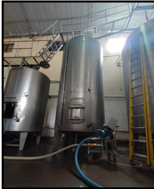
Figura 3- 3 Tanque de almacenamiento
