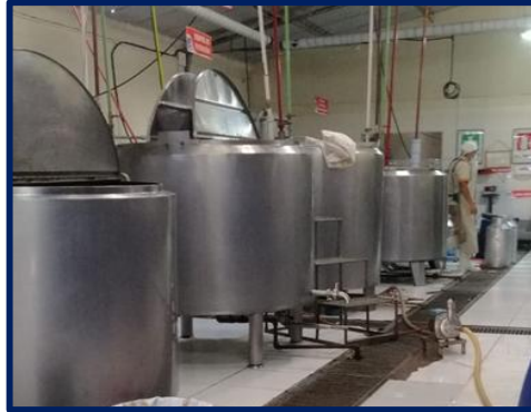
Fig.III-5. Tanques de cocimiento
