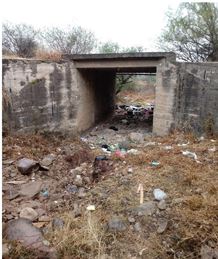
Fig. 6. Contaminación de quebradas.
