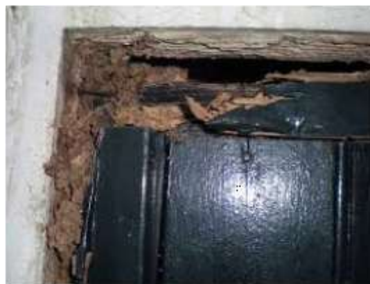
deterioro por presencia de agua
