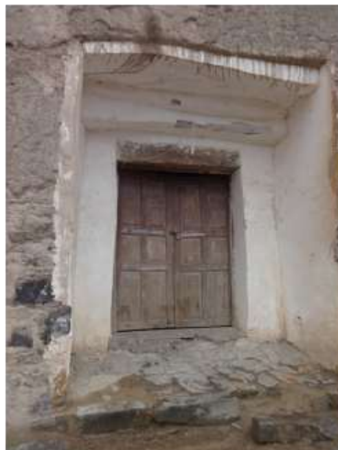
deterioro por falta de mantenimiento
