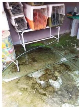
Figura 111 Fotografía de humedad en pisos Caniles y Gatiles
