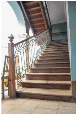
Figura 42. Escalera con Tablones de Madera.
